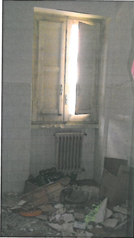
Situazione degli infissi e dei solai
